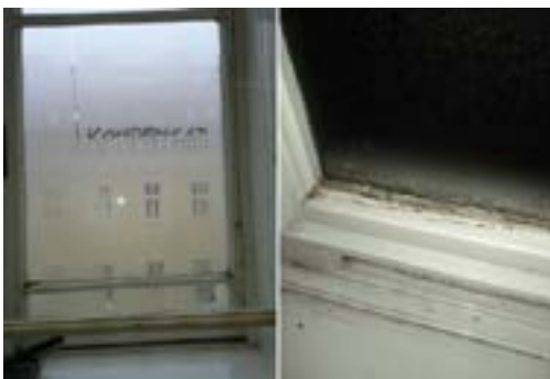
Bestand vor Sanierung: Thermisch inakzeptable, undichte Fenster mit Kondensatschäden
